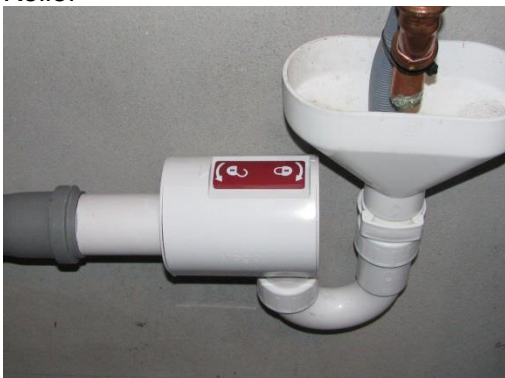
Rückschlagklappe Kondensatablauf Heizung
