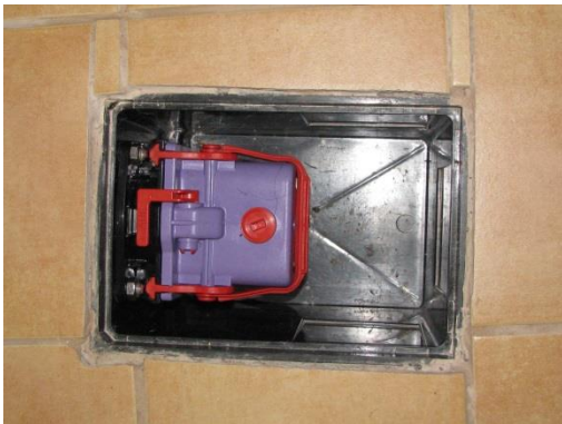
Rückschlagklappe in Bodenablauf im Keller
